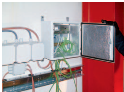
3. ábra. Vezérlőszekrények a hűtőházban. A Bluetooth modul a jobb oldali szekrény fölött látható. A vezérlőszekrény nincs fűtve. Az elektronika a hűtőházban uralkodó -25 °C-os hőmérséklet ellenére is megfelelően működik
