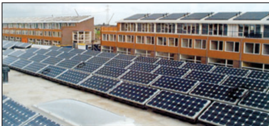
6. ábra. Napelemmodulok a háztetőn
